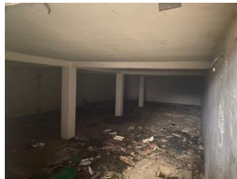
Foto F. Sitio donde se evidenció acumulación de basura y escombros
